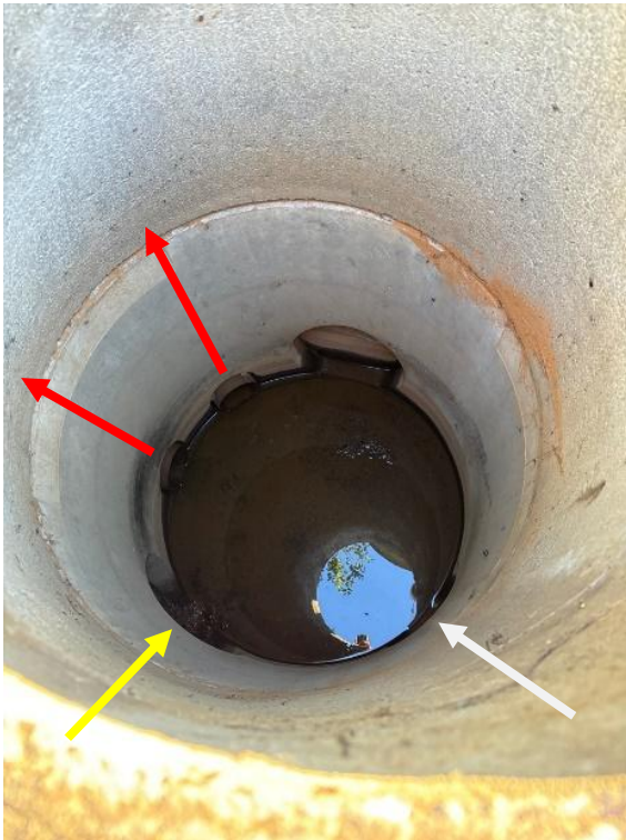
Figur 5.2: Drænbrønd 4d_br1 som afleder spildevand og regnvand fra Nørremarksvej 13. På foto er der med gul pil markeret det indløbsrør hvorfra spildevand og regnvand fra Nørremarksvej 13 ledes til, og med rød pil markeret to udløbsrør til markdræn. Den grå pil viser indløbsrør fra rørledning der kommer fra sydøst.
