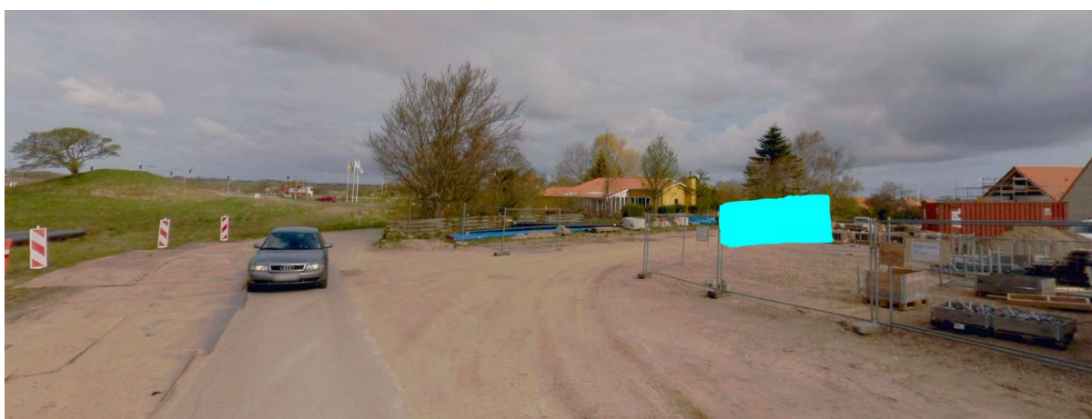
Figur 8. Cowi gadefoto 15. april 2024 med turkis markering af affaldsskurets omtrentlige placering set fra sydøst fra Getsøvej. Gravhøjen ses helt ude til venstre i billedet.
