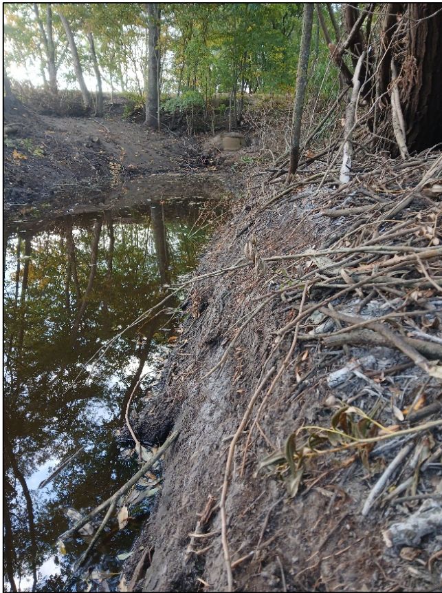
Billede 3: 1. oktober 2025 - Den nordøstlige brink er meget stejlt afgravet. Der ses rødder fra piletræerne der stikker ud fra jordsøjlen.
