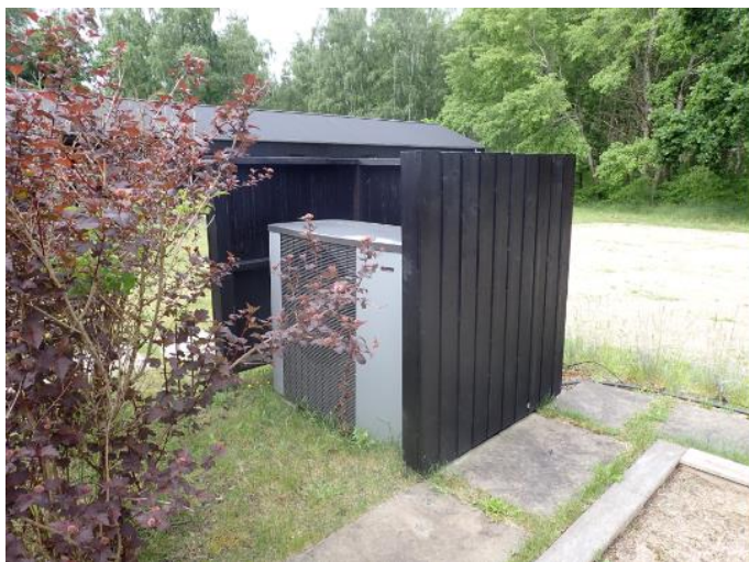
Figur 30. Varmepumpe med afskærmning ved bygning nr. 1.
