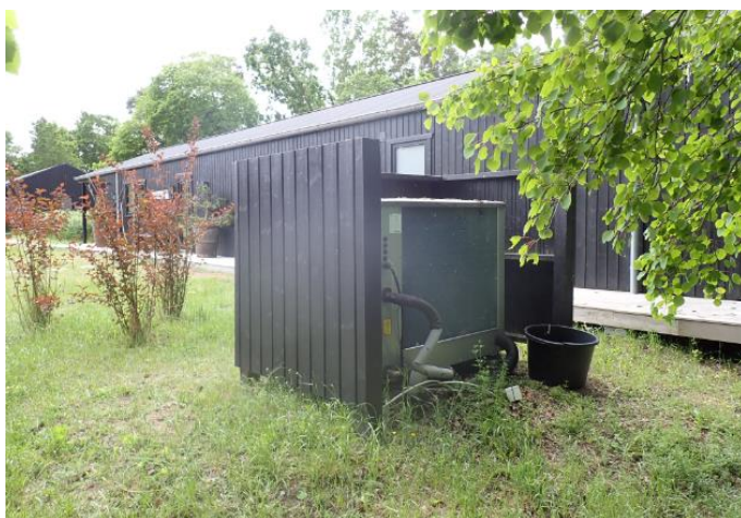
Figur 29. Varmepumpe med afskærmning ved bygning nr. 3.
