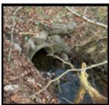
Rør under adgangsbroen til Malergården
