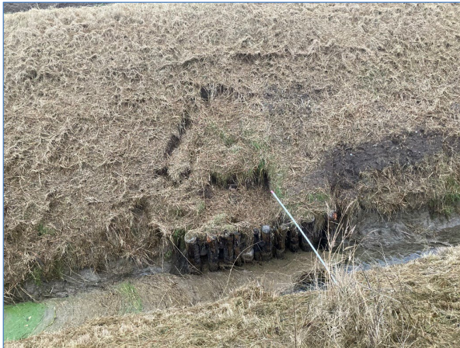
Figur 1 – Projektstrækning, hvor brinken skrider ned overfor regnvandsudløbet.
