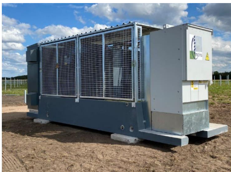
Figur 10. Eksempel på transformer (fra miljøvurderingen).
