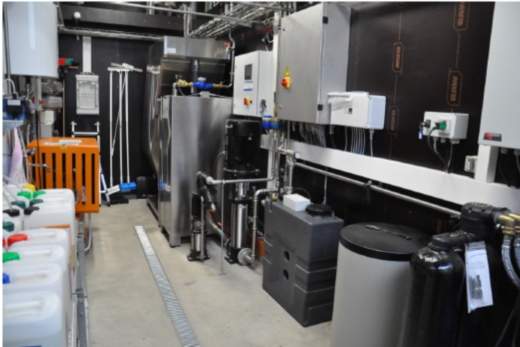
Fig. 2.2 Teknikrum med Bio Classic vandrensningsanlæg
